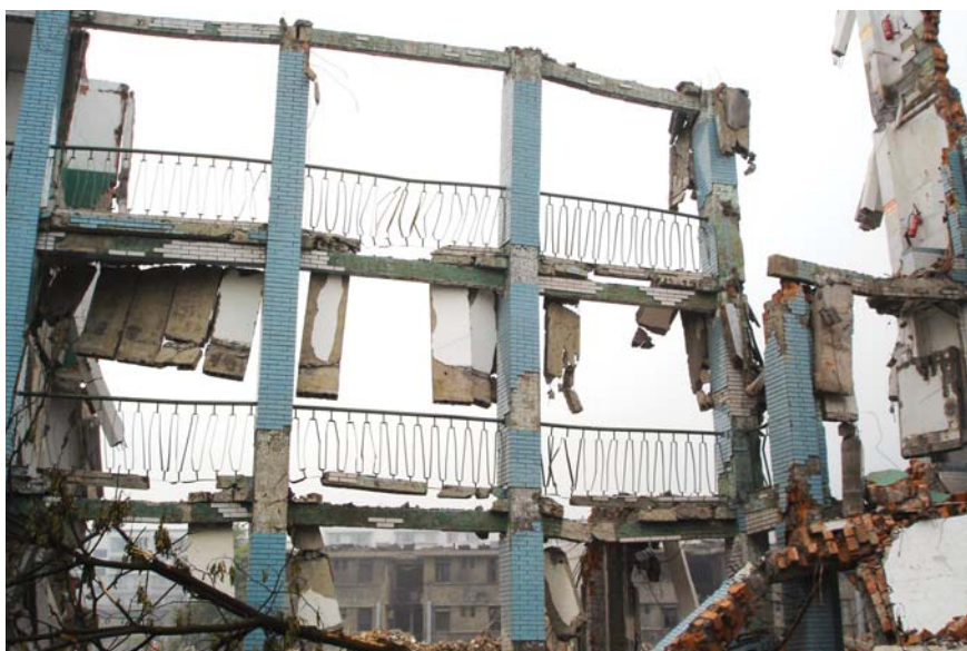
地震后的惨烈景象——教学楼只剩断壁残垣
