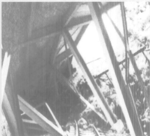
1978年1月14日7.0级伊豆大岛近海地震，死25人， 下水隧道口工程被震毁
