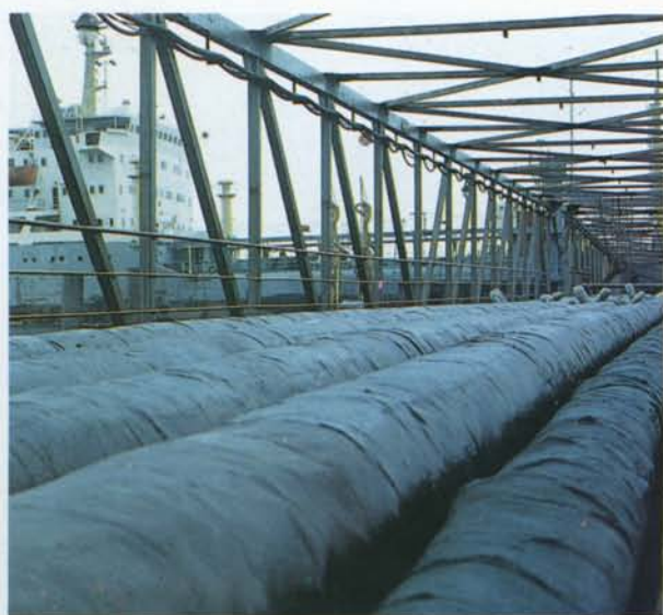
江畔油龙—鲁宁输油管道
