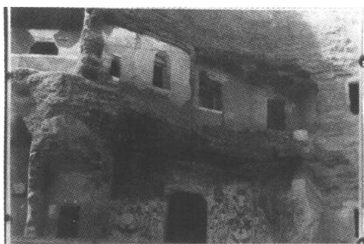
图 1-6 莫高窟加固工程前残破现状
