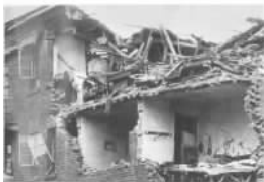
楼房垮倒坍塌
