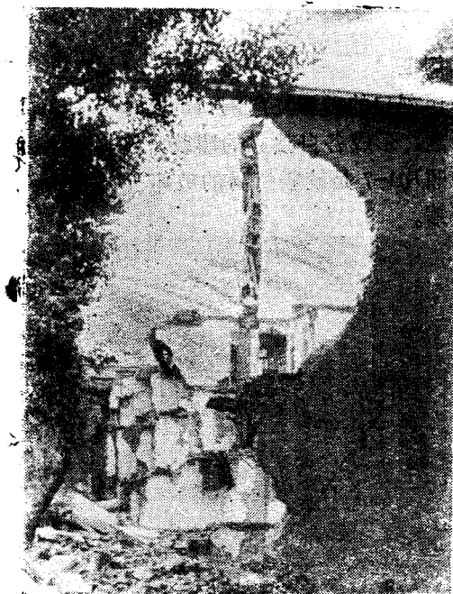
照片1 5 砖墙剪切破坏的典型例子
