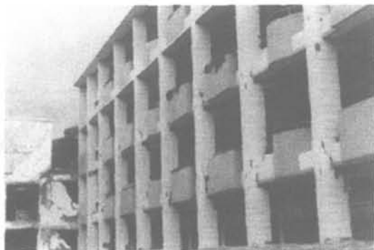
图 1.11 梁柱接头破坏
