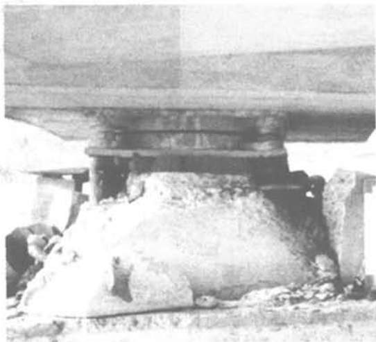
图 1.9 桥梁支座压碎
