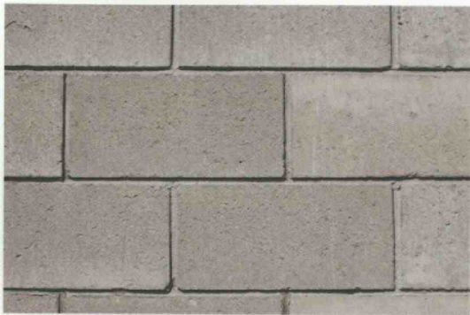
图4-2 国内的混凝土砌块加工还未达到应有的质量
