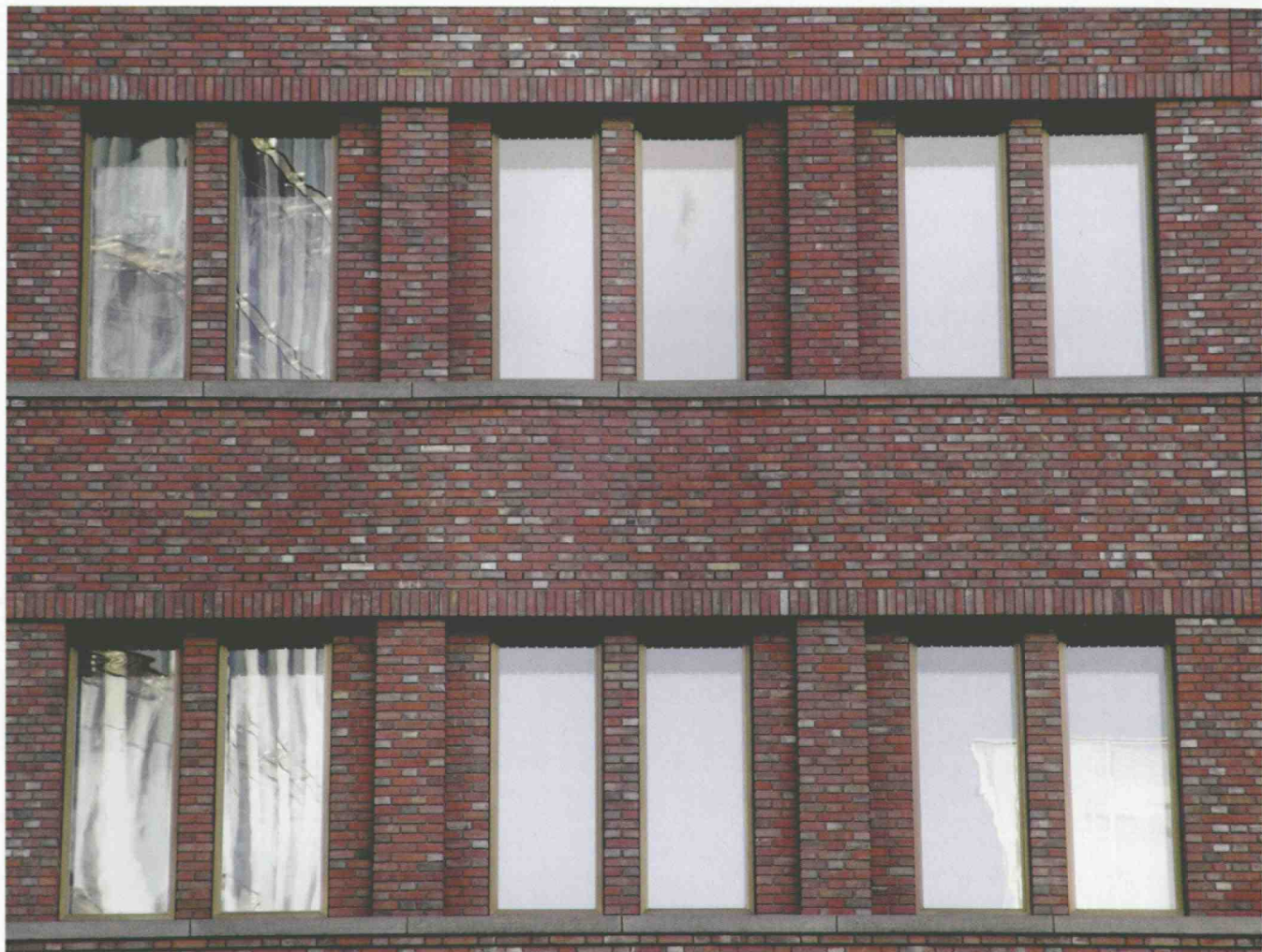
图4-13 德国柏林波茨坦广场上的克尔霍夫(Kollhoff-Gebäude)大楼是较为少见的以砌体作为外饰面的高层建筑
