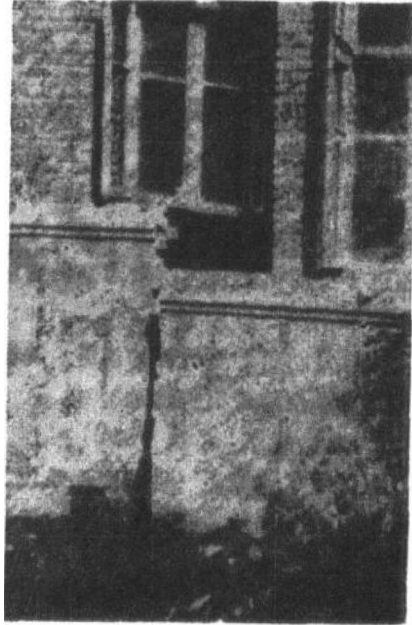
图 1.4 因地陷使房屋破坏
