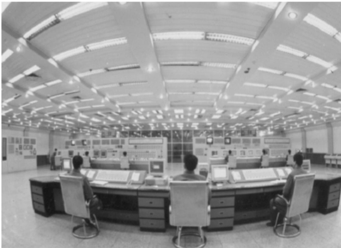
火电厂集控室
