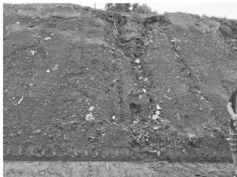
图 3.1 老路基边坡垮塌
