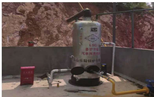
图7 发酵罐循环加热锅炉
