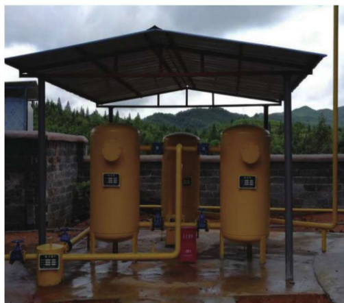
图6 沼气净脱硫、脱水净化间
