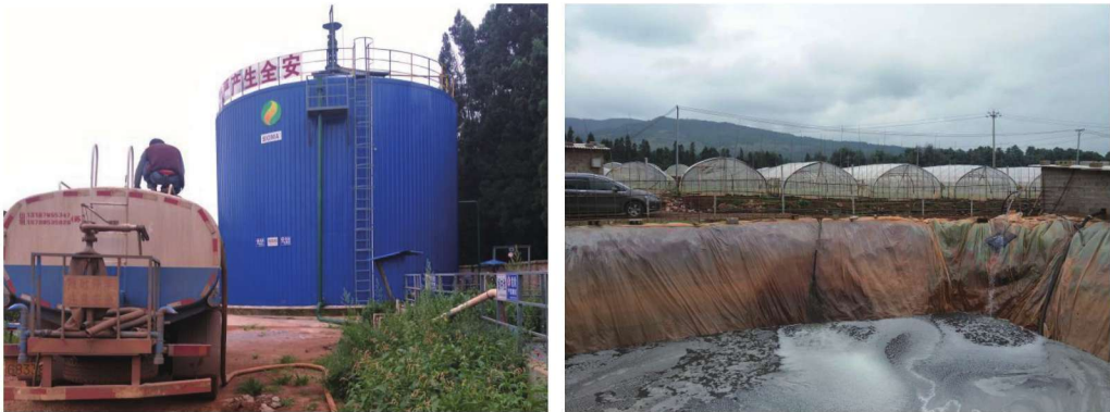
图11 沼液罐及田间水肥池
