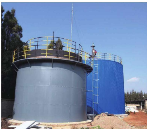
图5 中温厌氧发酵罐、湿式储气柜
