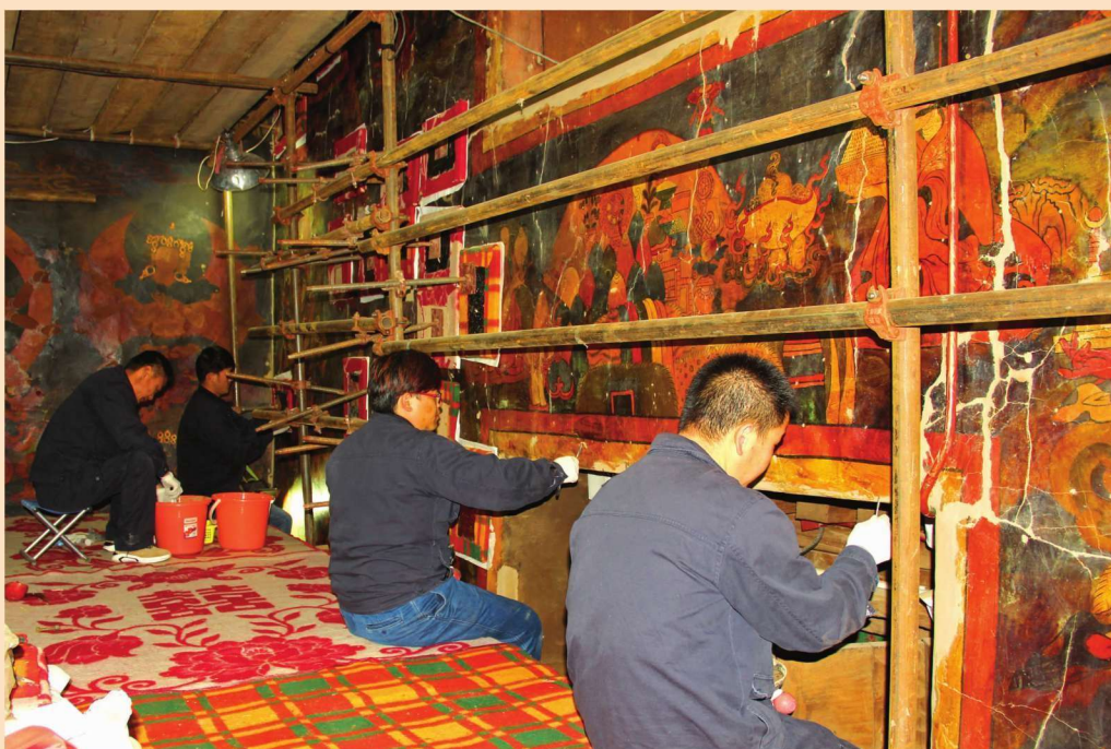
甘南夏河拉卜楞寺下续部学院灵塔殿东壁破损、空鼓修复
