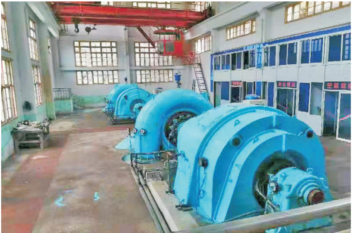
青印溪二级电站
