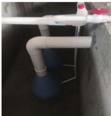
图 2-5 气提泵的实景照片
