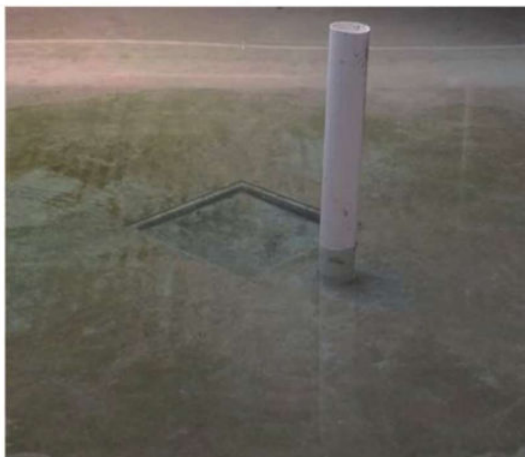
图 2-1 中央排污口及排鳊管实景图
