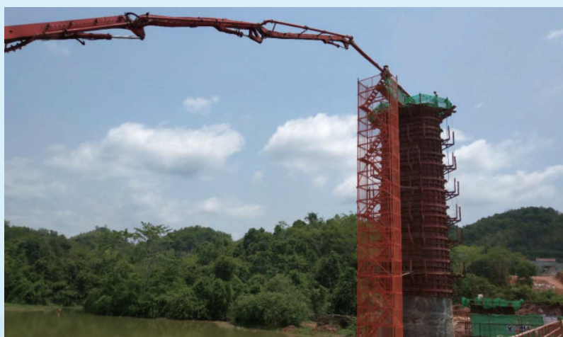
正在进行桥墩水中施工的中老铁路V标楠松河大桥，由水电十五局承建
