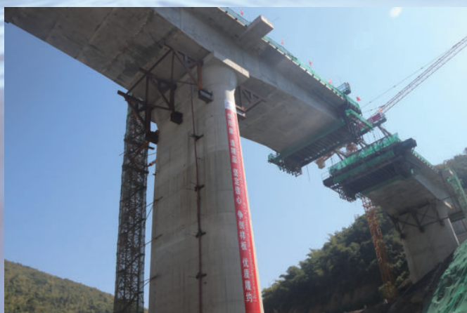
中老铁路IV标沙拉巴士车站三线大桥，由水电三局承建
