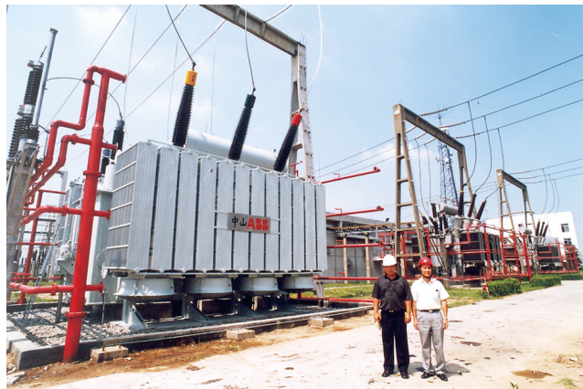
2000年8月，中山 ABB 第一台 220 千伏 150 兆伏安变压器在中山小榄变电站投入运行
