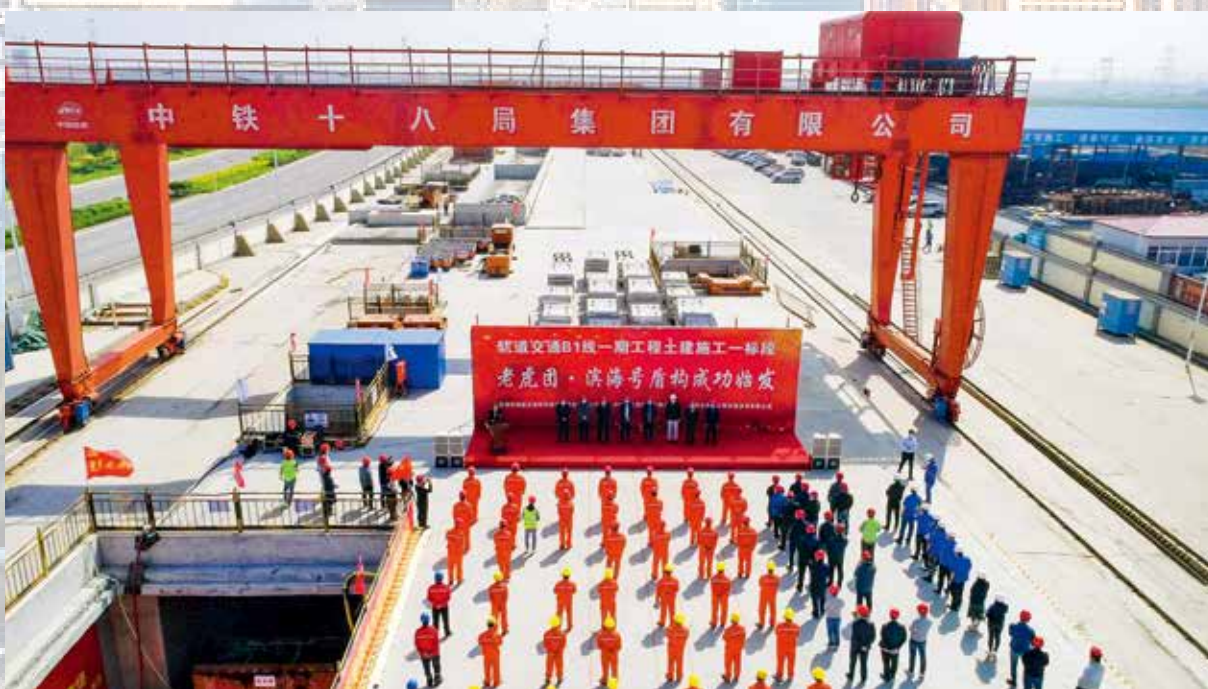
5月6日，轨道交通B1线一期工程土建施工一标段盾构始发 滨海建投集团 供稿
