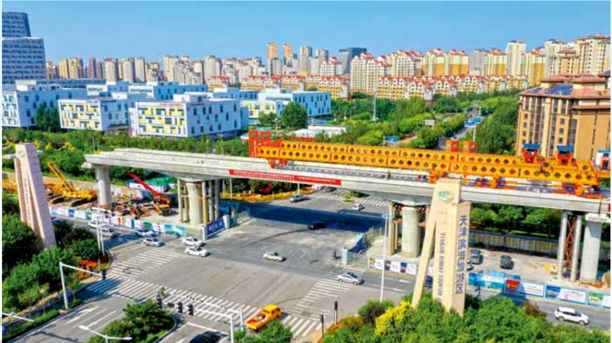
9月，滨铁2号线首联U箱组合预制悬拼连续节段梁顺利合龙
