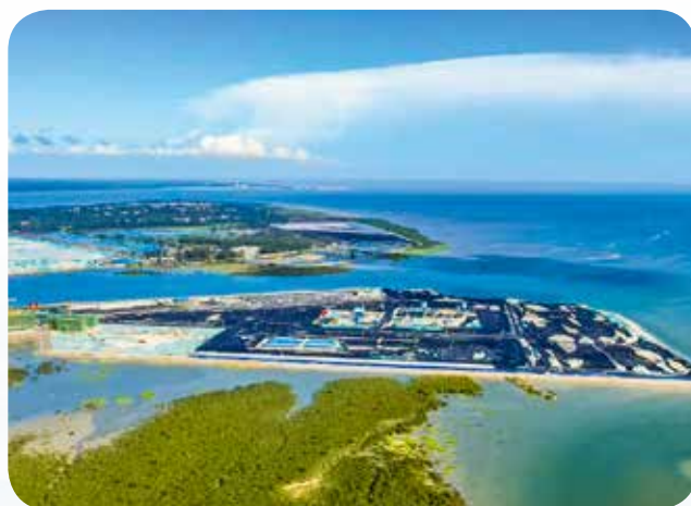
▲ 2015年10月30日，铁山港东岸码头顺利开工。图为雏形初现的铁山港东岸码头
