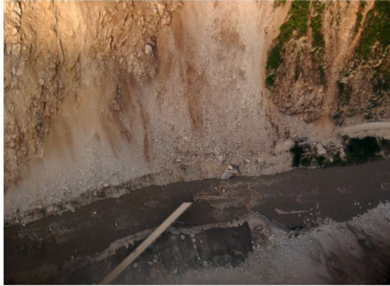
图 1.3 崩塌砸断桥梁、掩埋路基
