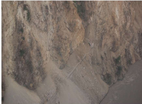
图 1.4 隧道洞口及路基震害
