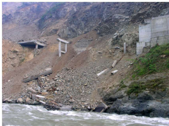
图 1.6 崩塌砸断桥梁
