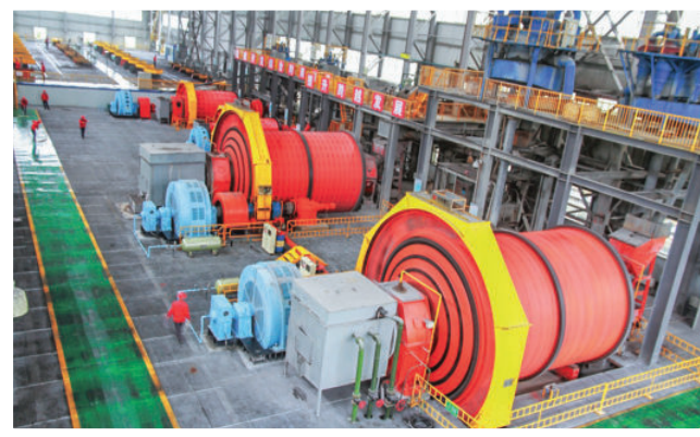
成县厂坝公司选矿厂选矿车间一角
