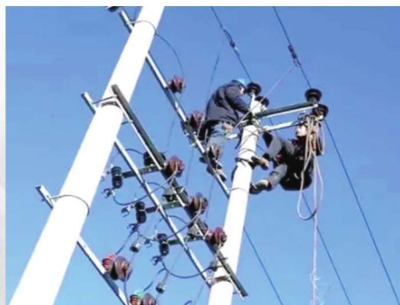
耀州区贫困村农网升级改造工程
