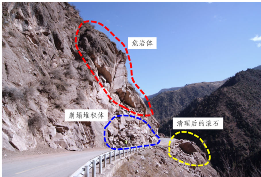
(a) 危岩体崩塌、滚石及灾害清理
