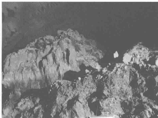
图 1.5 未按设计工法开挖
