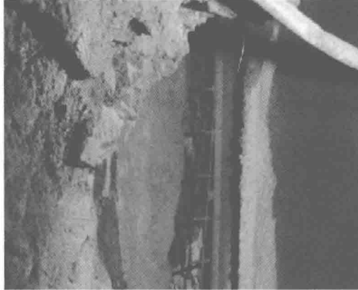
图 1.15 钢筋网片未居中、紧靠
