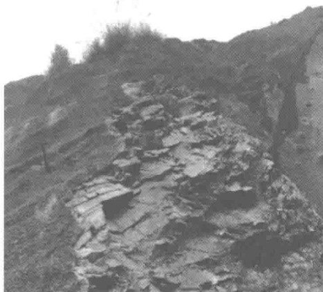
图 1.2 洞口混凝土剥离
