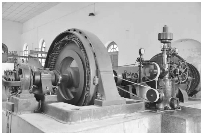
图 1-2 石龙坝水电站内景
