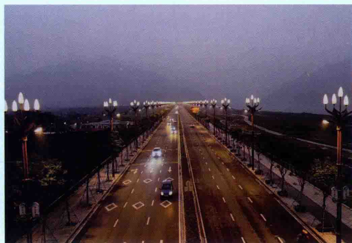
广东省肇庆市景福围江滨堤路改造工程，由水电六局承建
