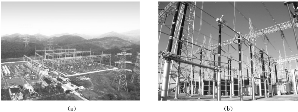
图 1-5 变电站外观图 (a) 变电站全景图；(b) 变电站局部图
