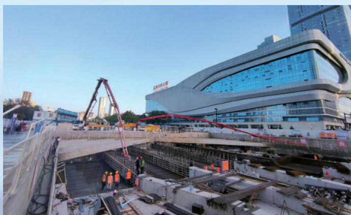
由水电四局承建的河南省洛阳市地铁 1 号线 2 站 2 区间工程，正在进行盾构施工
