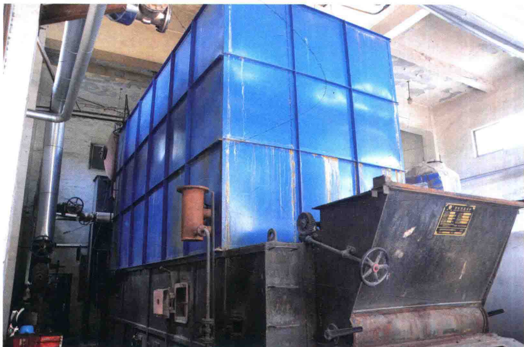
改造前的 6t 燃煤锅炉
