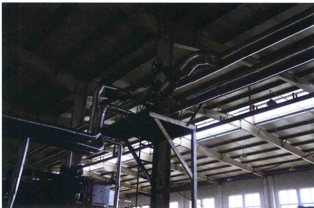
改造前贯穿车间的导热油管一角
