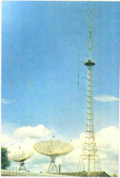
丙村衛星地面接收站
