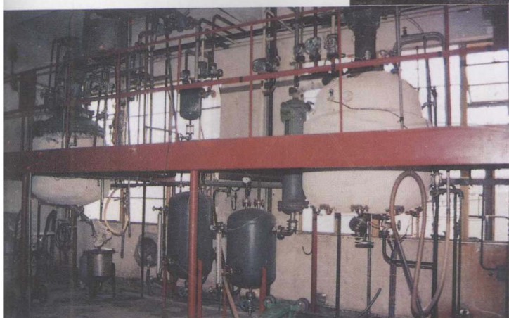
中试车间一角
