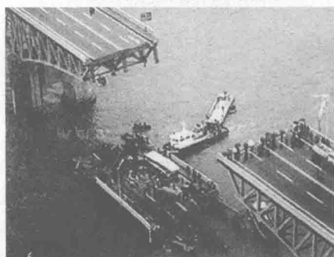
(c) 韩国圣水大桥中间跨断裂
