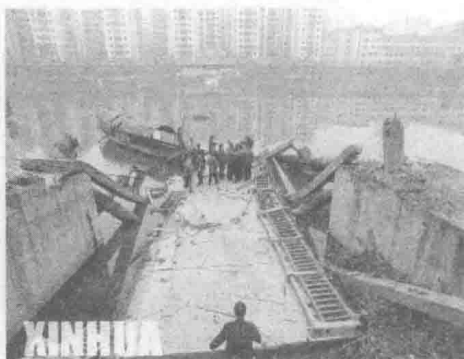
(b) 重庆綦江彩虹大桥突然倒塌
