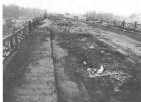
图 1-11 陕西榆林草沟大桥油罐车起火
