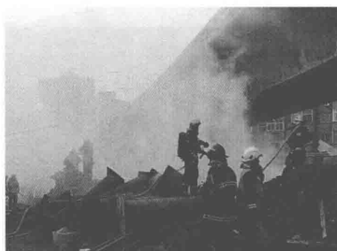
图 1-23 山西太原双塔西街高架桥焊接不当引发火灾
