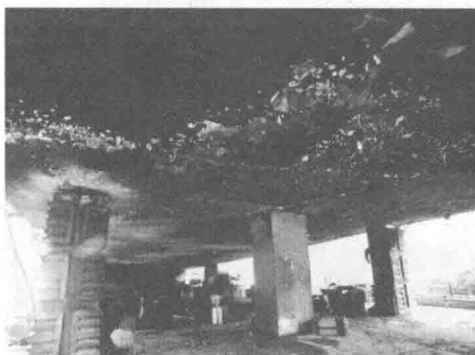
图 1-15 西安东二环互助路立交桥堆积物引发火灾
