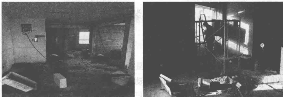
图 1-2 装修施工临时用电不规范举例
