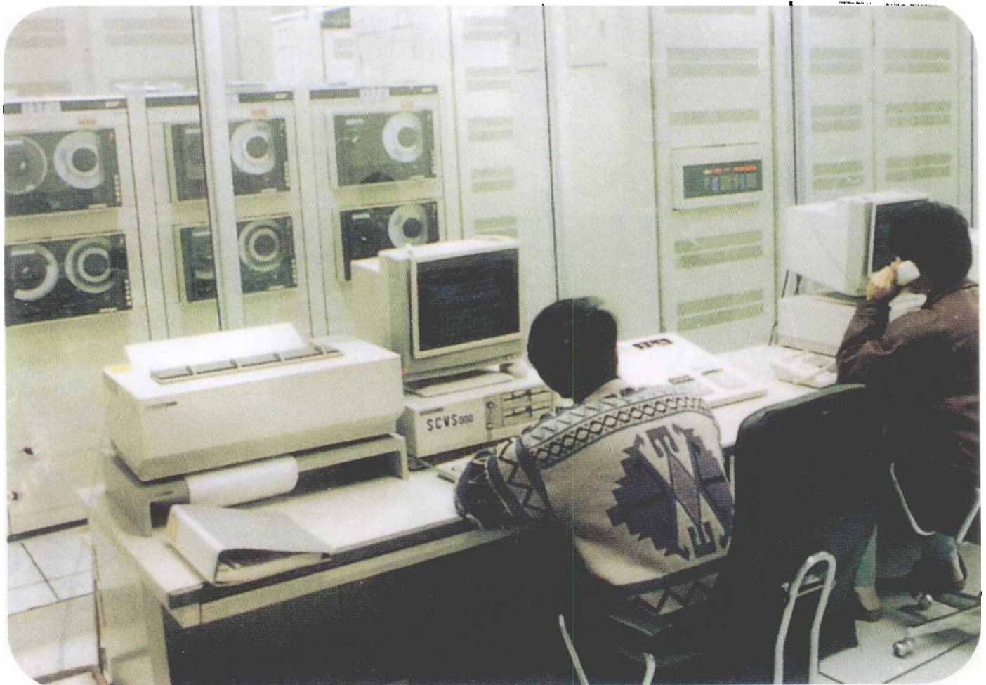
万门程控电话交换机房
