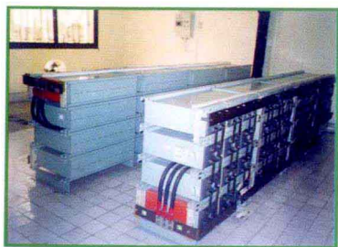
1995 年县局电力室封密式蓄电池
