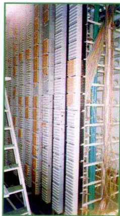
九十年代县局机房配线架。
