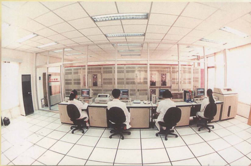
第一长途交换局机房。
