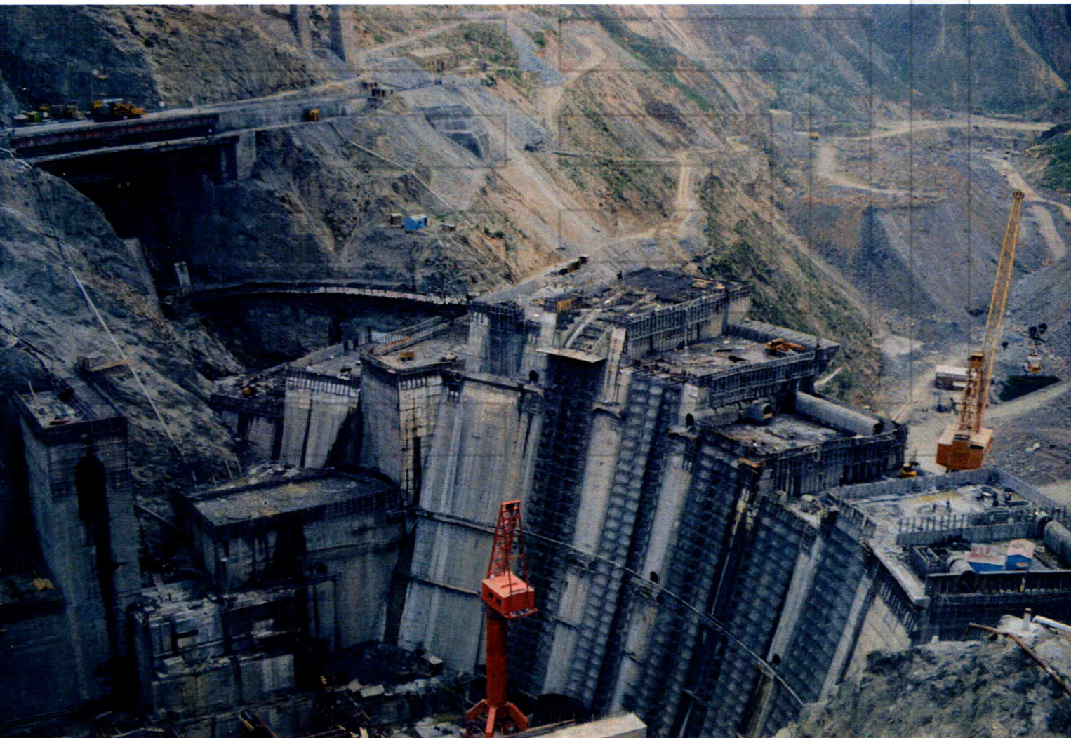
青海省重视开发水力资源，正在建设中的国家重点工程李家峡水电站已初见规模。 达哈甫 摄影
