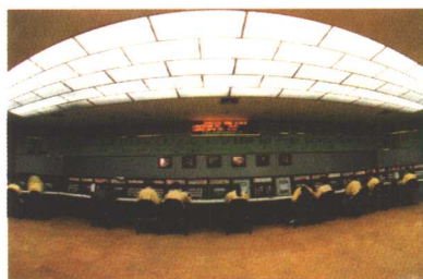
乙烯装置控制中心
