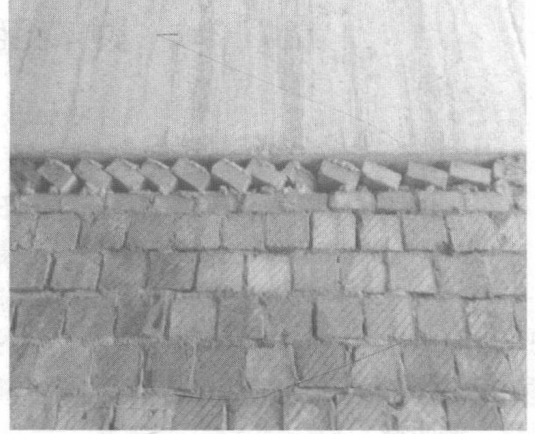
图 2-2 墙体顶部斜砌砖灰浆饱满度差
