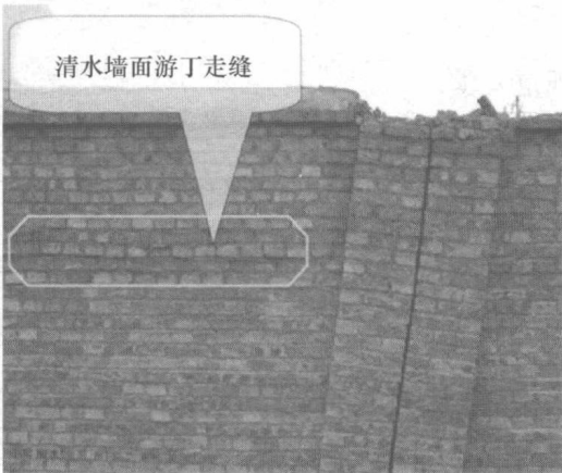
图 2-3 墙体出现游丁走缝
