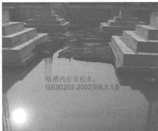
图 1-9 基础完工后未及时回填
