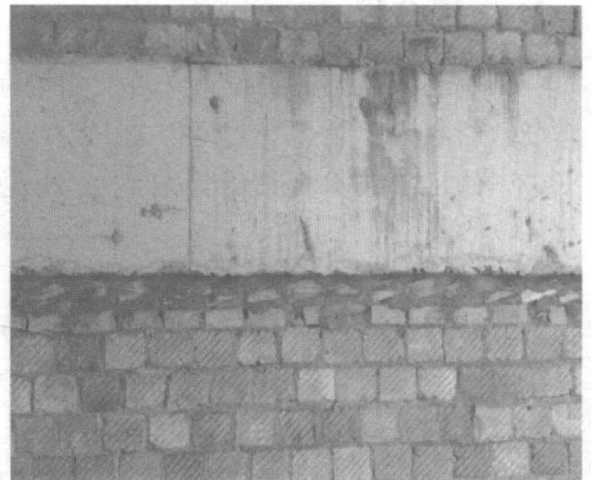
图 2-4 墙体顶部斜砌砖砌筑不正确
