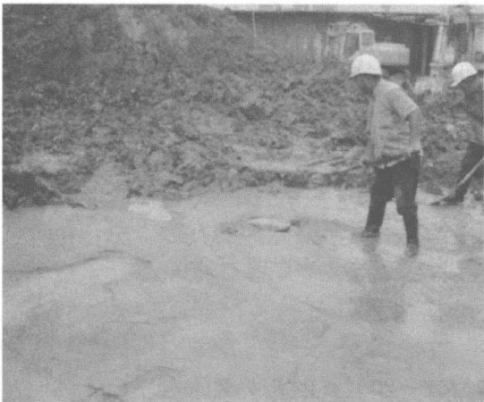
图 1-5 基坑管涌流沙
