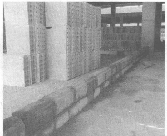
图 2-6 墙体砌筑灰缝不饱满
