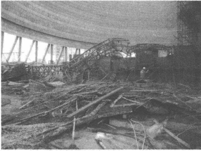
图 1.1-3 江西丰城电厂滑模垮塌事故
