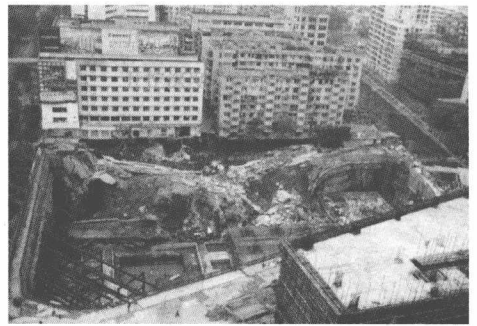
图 1.1-6 广州建筑基坑坍塌事故
