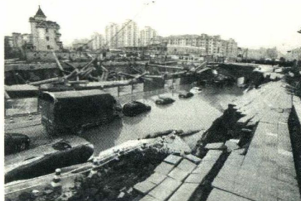
图 1.1-4 杭州地铁基坑坍塌事故
