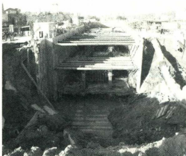
图 1.1-5 北京地铁基坑坍塌事故
