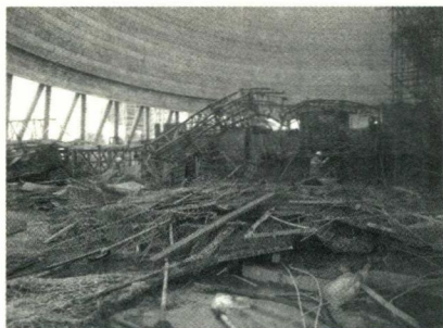
图 1.1-3 江西丰城电厂滑模垮塌事故
