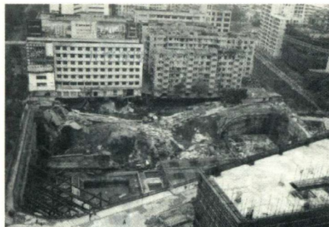
图 1.1-6 广州建筑基坑坍塌事故
