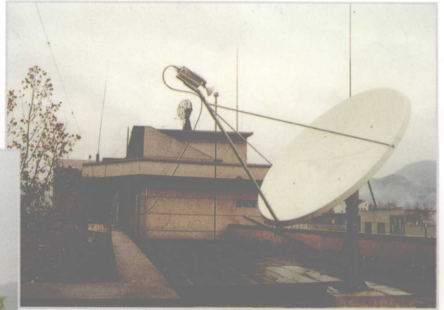
铜仁气象局 VSAT 天线
