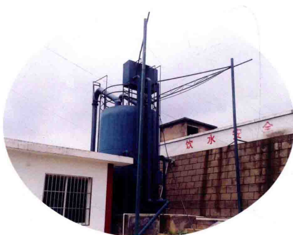
龙家供水站水处理设备
