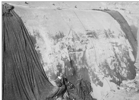
图 1.2.3.1 边坡养护不到位存在粉化
