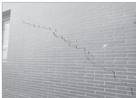
图 1.1.3.1 地基产生不均匀沉降
