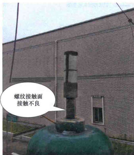
图 1-1 2 号主变压器 110kV-侧 B 相套管将军帽
