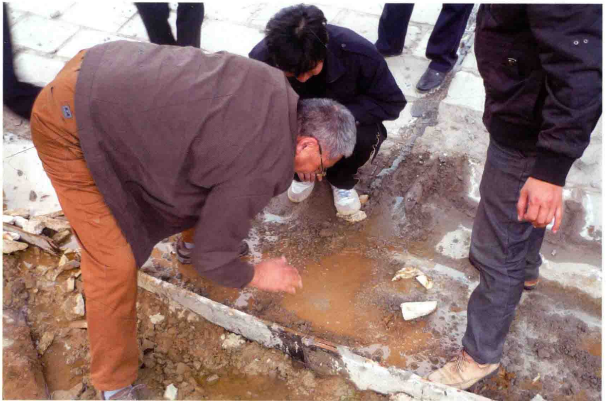
2012年11月，东线鲁北小运河渠道坡脚混凝土齿墙举报调查
