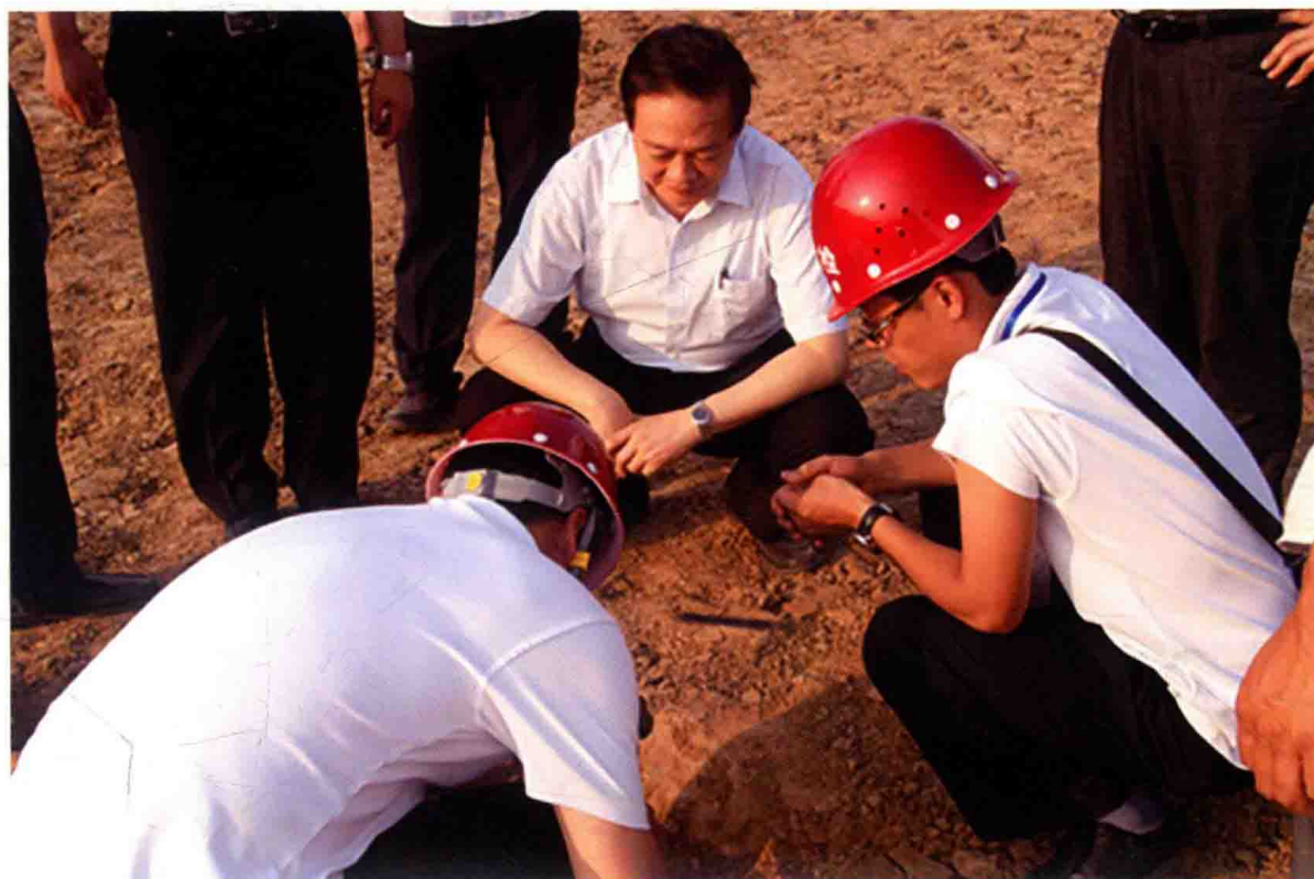
2011年6月，国务院南水北调办副主任于幼军检查中线潮河段渠道高填方工程质量
