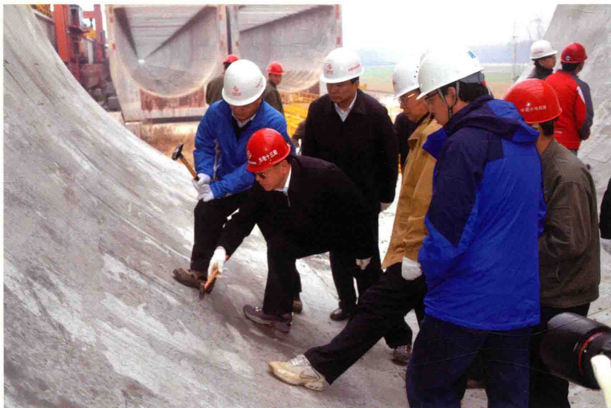
2012年11月，国务院南水北调办副主任蒋旭光检查沙河渡槽混凝土质量
