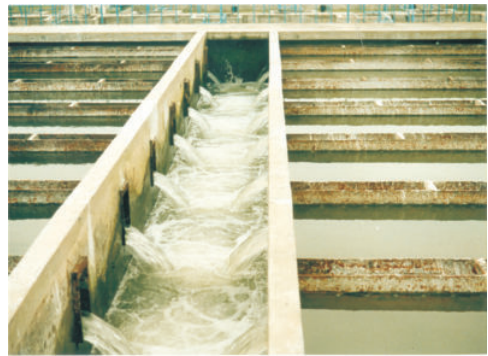
21世纪初建的三乡自来水厂(摄于2005年)
