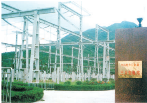
1997年建成投产的22万伏变电站(摄于2005年)
