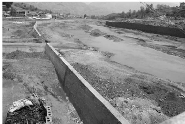
图 1.1-3 堤防侵占河道滩地
