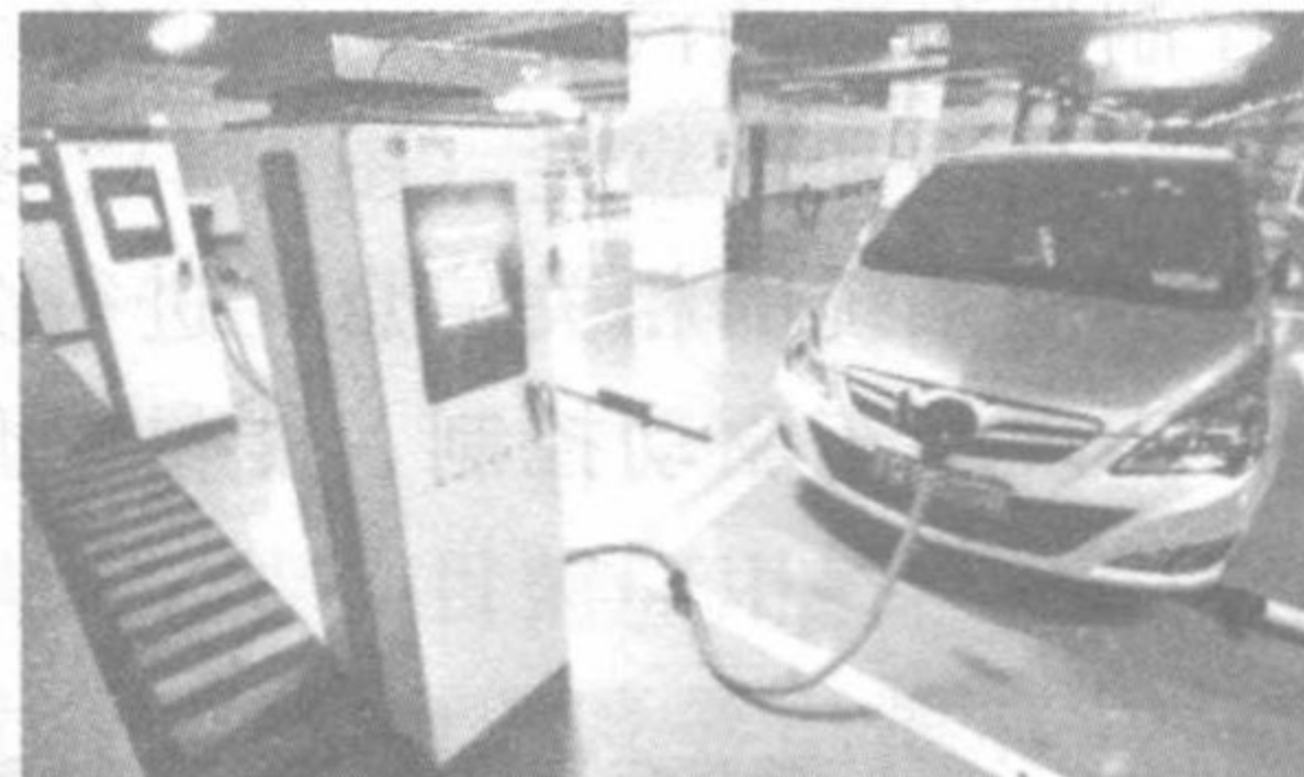
图 1-6 充电桩快速充电
